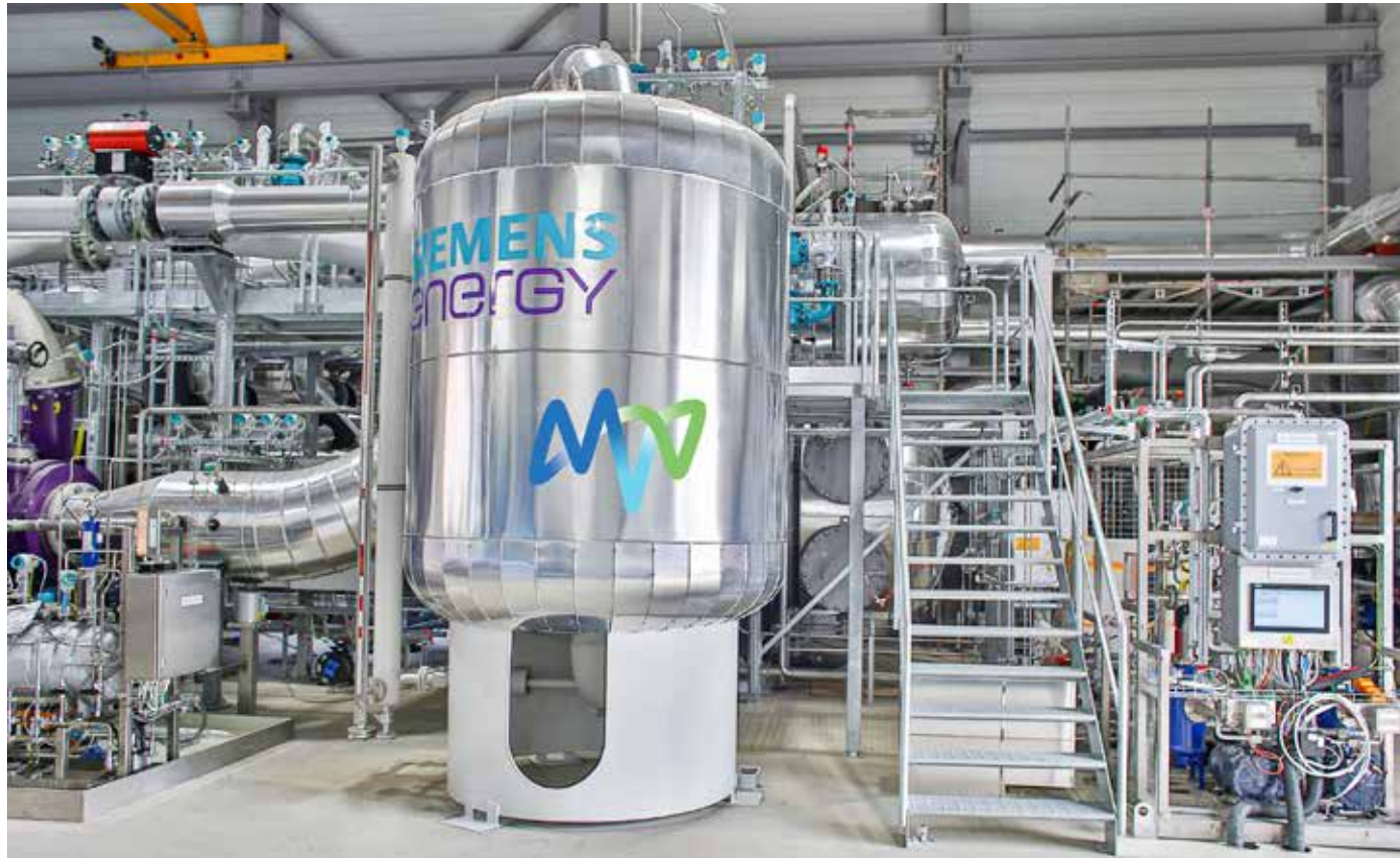
Mit Flusswärmepumpen treibt die MVV die Wärmewende in Mannheim und der Region voran. Die innovativen Großwärmepumpen gewinnen Wärme aus dem Rhein und speisen sie in das Fernwärmenetz ein
