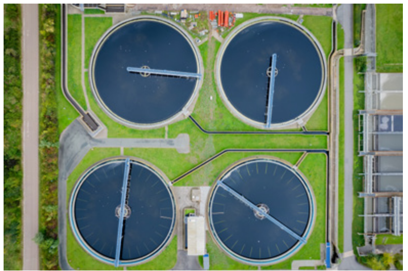
Klärwerk von oben – hier sind vier der sechs Nachklärbecken zu sehen. Diese stellen die letzte Reinigungsstufe im Klärwerk Erfurt dar
